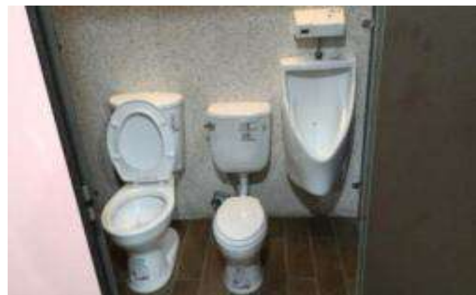
性別友善廁所內針對不同使用於不同廁間設置不同便器。
